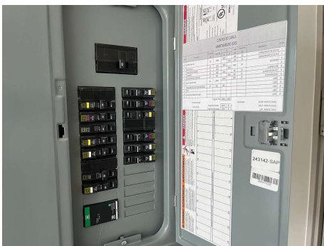
CAJA DE BREAKERS
